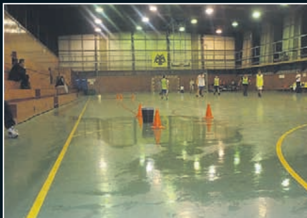
Οι αθλητικές εγκαταστάσεις Αχαρνών εκπέμπουν S.O.S! Η εικόνα μετά τις βροχοπτώσεις...
